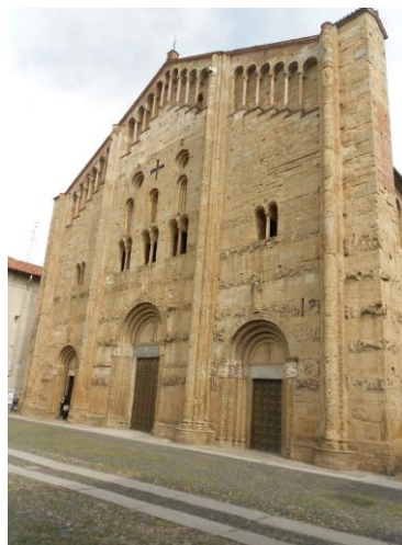
Fig. 4. La facciata della chiesa di San Michele in Pavia è costituita da pietra arenaria, soggetta a importanti fenomeni di degrado.
